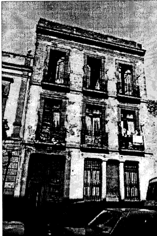
Fotografía no. 2 – Vecindad (también conocida como conventillo ) deteriorada.
